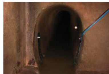
Point de mesure de débit
