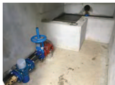
Captage de source
