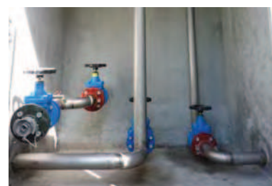
Chambre de vanne de réservoir
